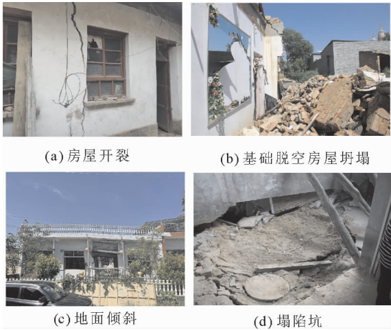
图 1 典型塌陷照片 Fig. 1 Typical collapse photo
